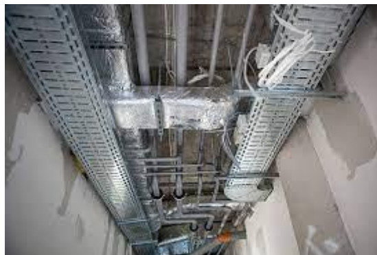
Figura 150 – Rede de Utilidades entre forro (Elétrica, Climatização, Gases, Hidráulica)
